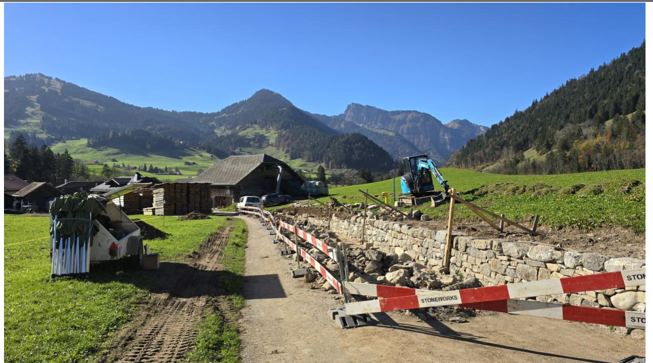
Foto 2: In Château-d'Oex wurde die Mauer entlang der Route du Pré, IVS-Abschnitt von nationaler Bedeutung, grösstenteils als Trockensteinmauer restauriert (Foto: SL-FP).
